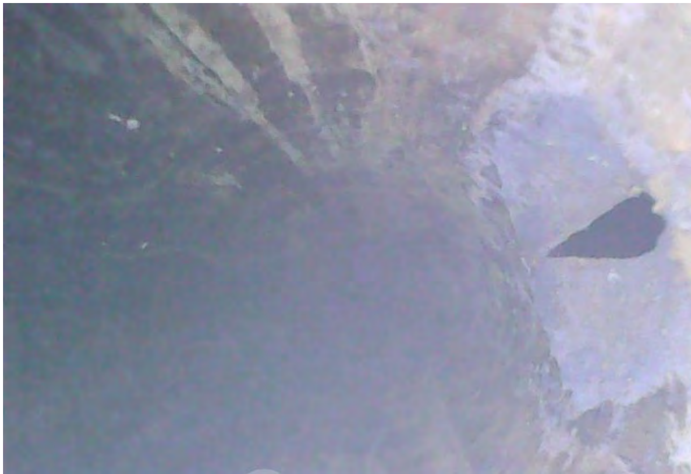
Повреждение теплообменной трубки на углублении
