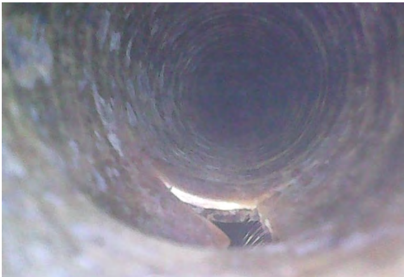
Повреждение теплообменной трубки на углублении 2 м от трубной доски
