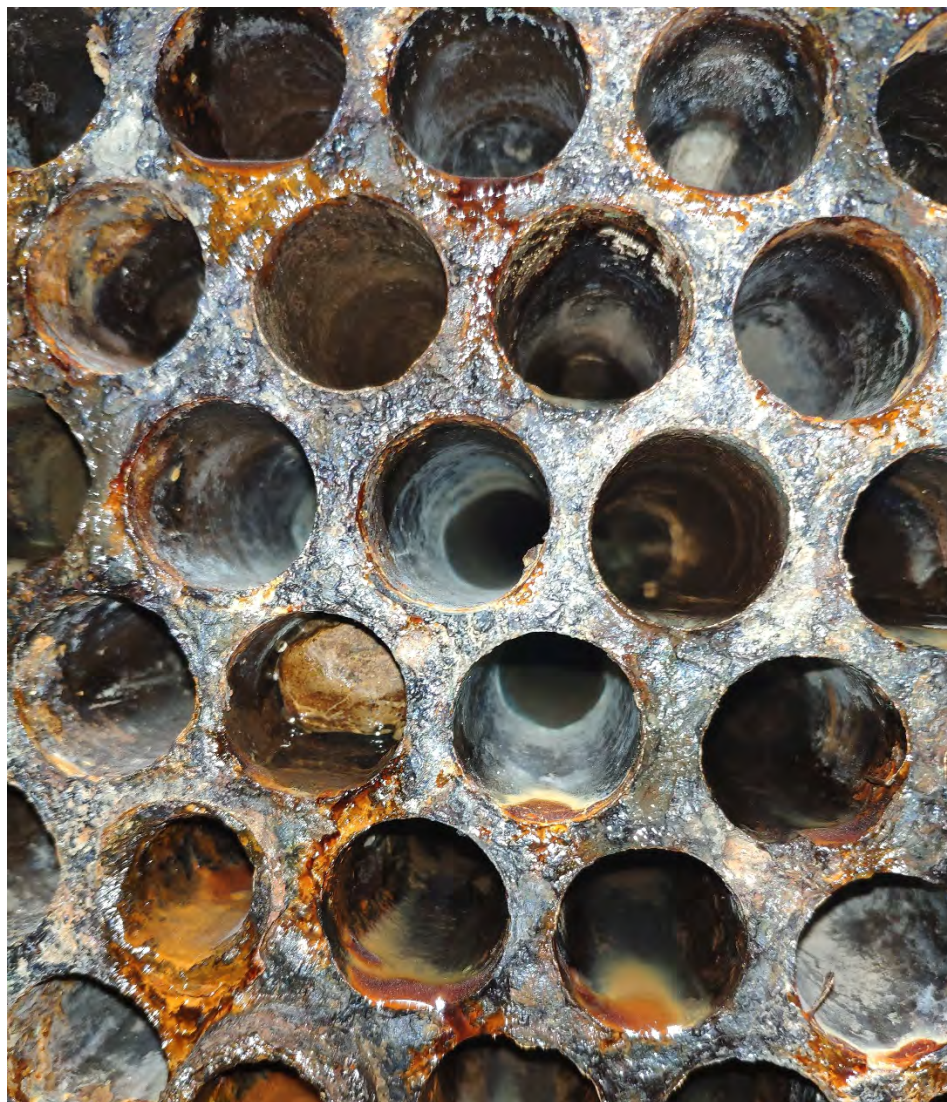
1. Эрозия входных участков теплообменных трубок
