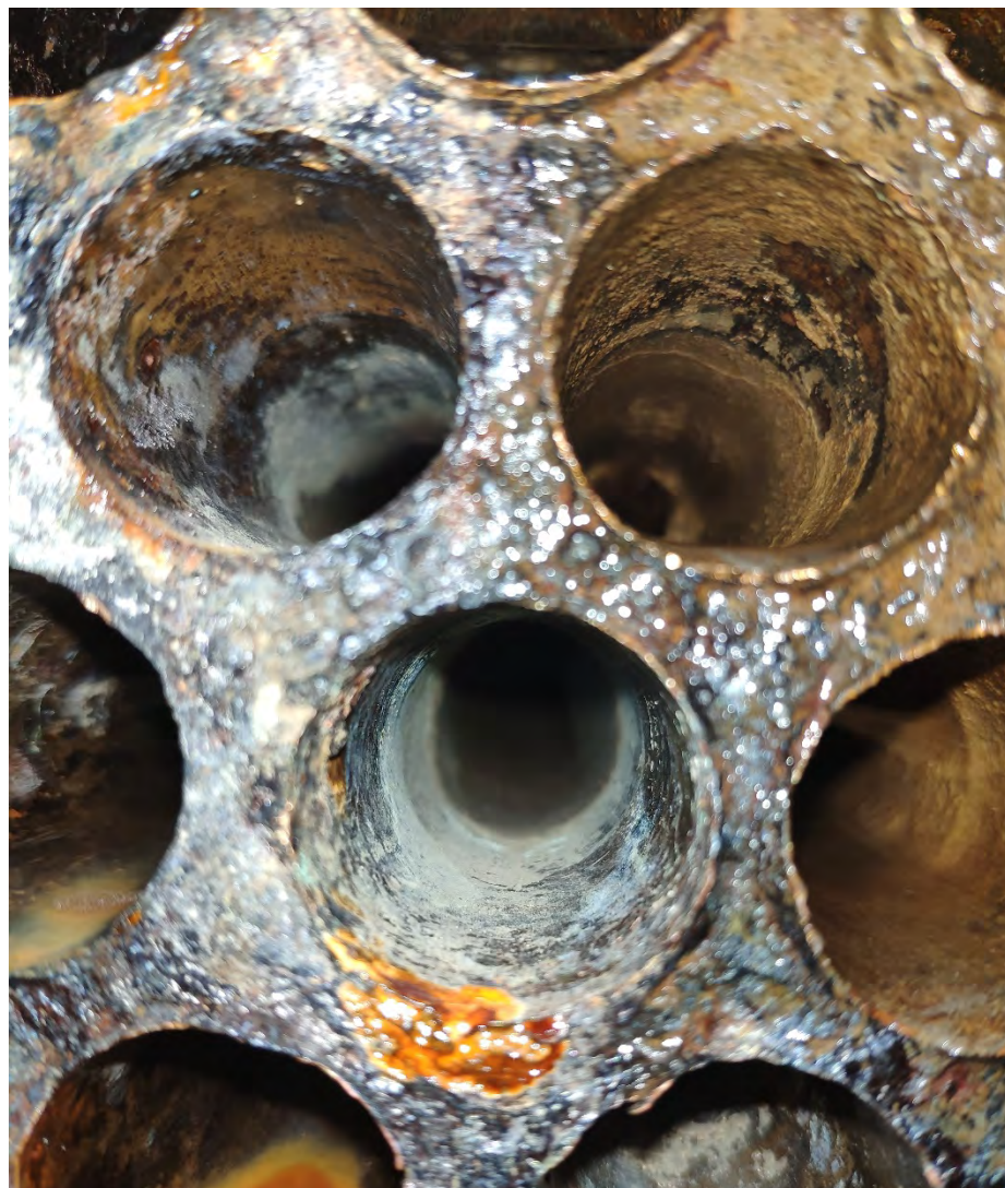
2. Эрозия входных участков теплообменных трубок
