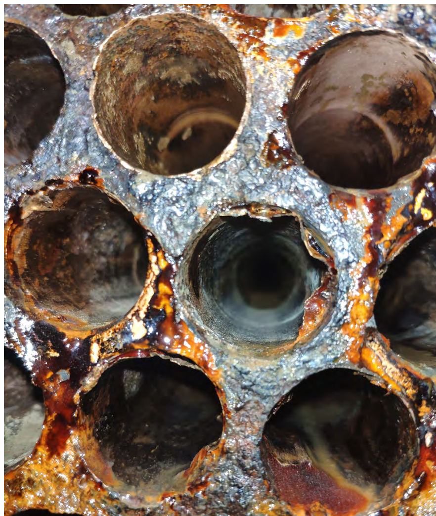
3. Деформация выступающих концов трубок вследствие эрозии входных участков
