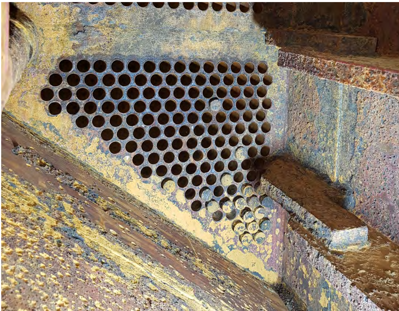
3. Заглушенные трубки в одном ходу второй секции
