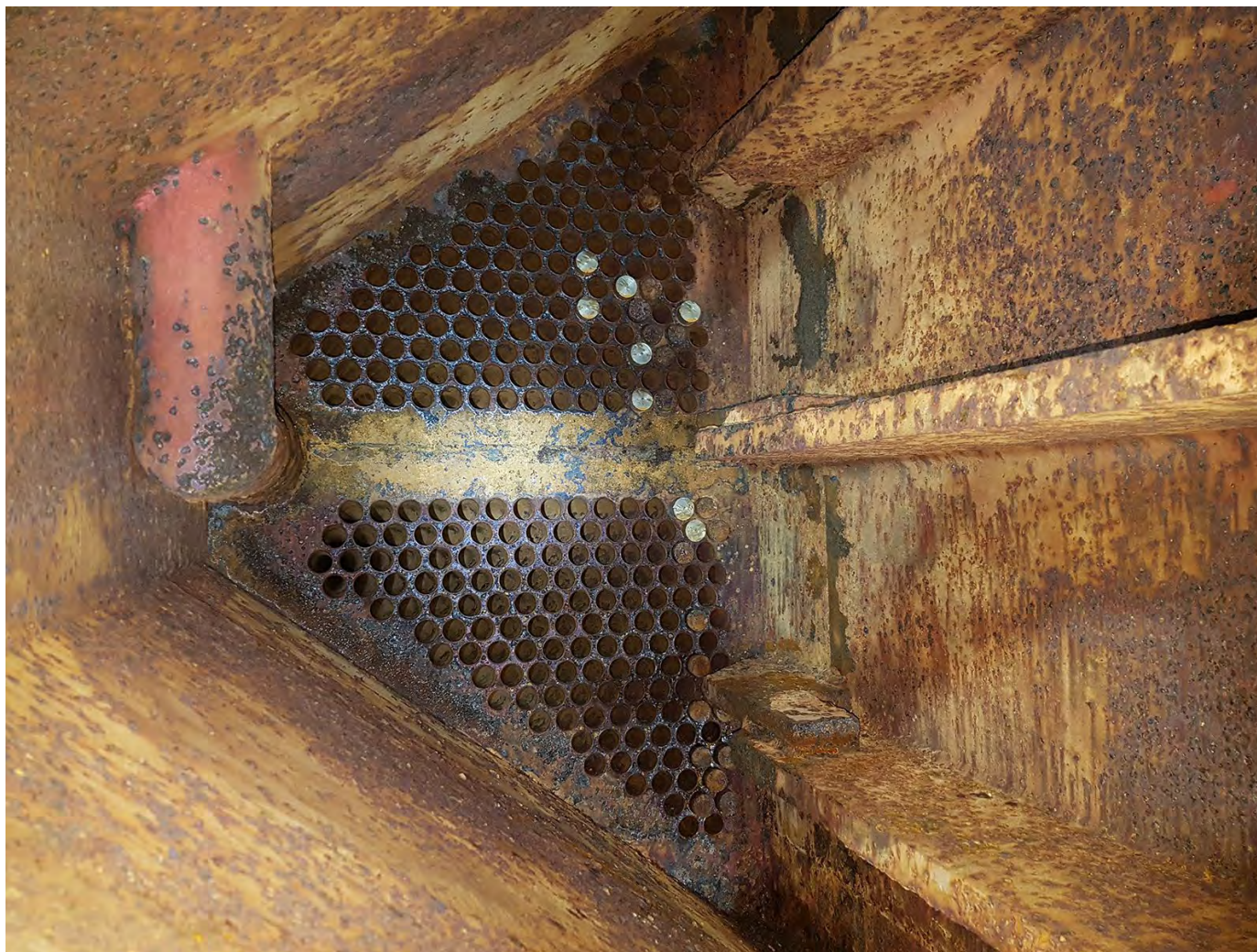
2. Заглушенные трубки в одном ходу первой секций
