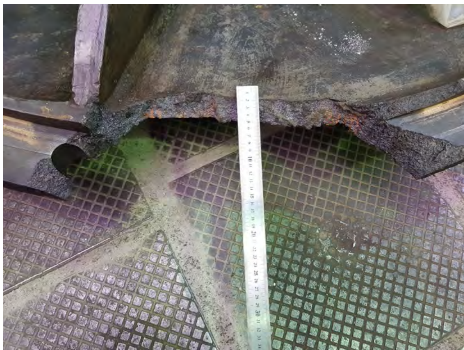
Вылом №2 крышки гидроагрегата
