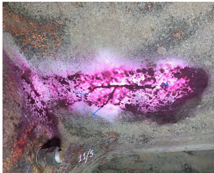
Определение объемов работ с помощью цветной дефектоскопии (3)
