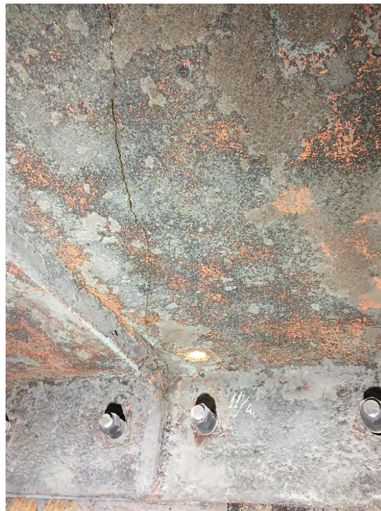
Трещина в тюбинге до начала выполнения работ. Длина трещины 1700 мм
