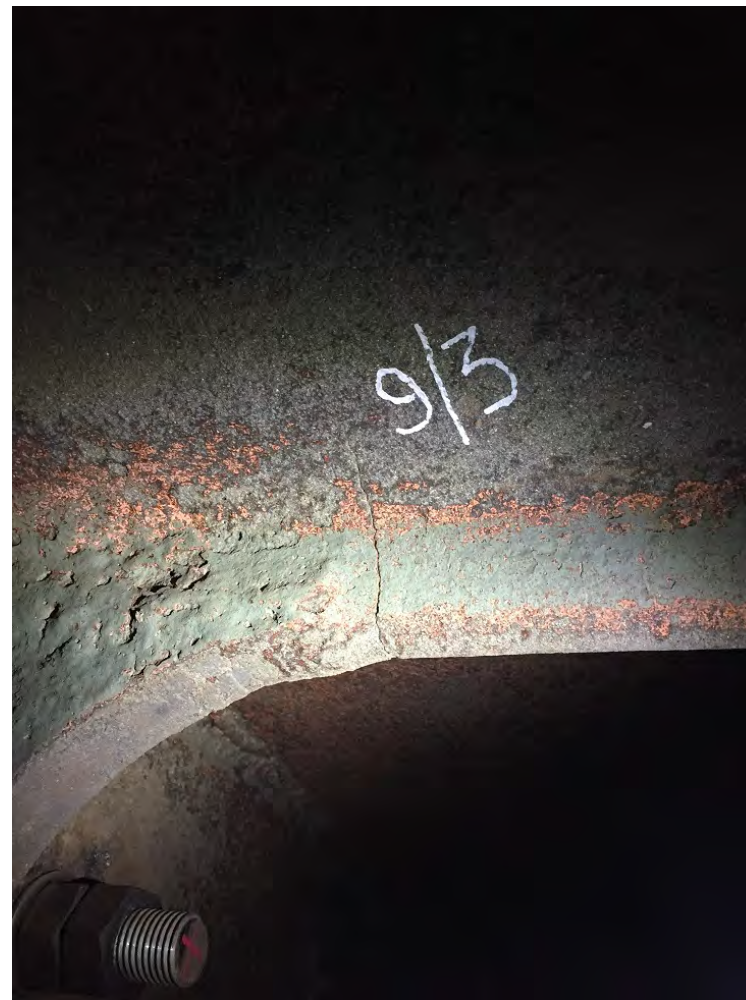
Трещина в чугунном тюбинге моста до начала работ
