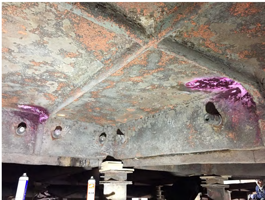
Определение объемов работ с помощью цветной дефектоскопии (2)
