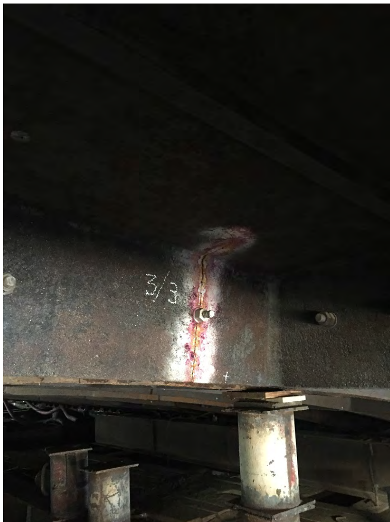
Трещина в чугунном тюбинге моста
