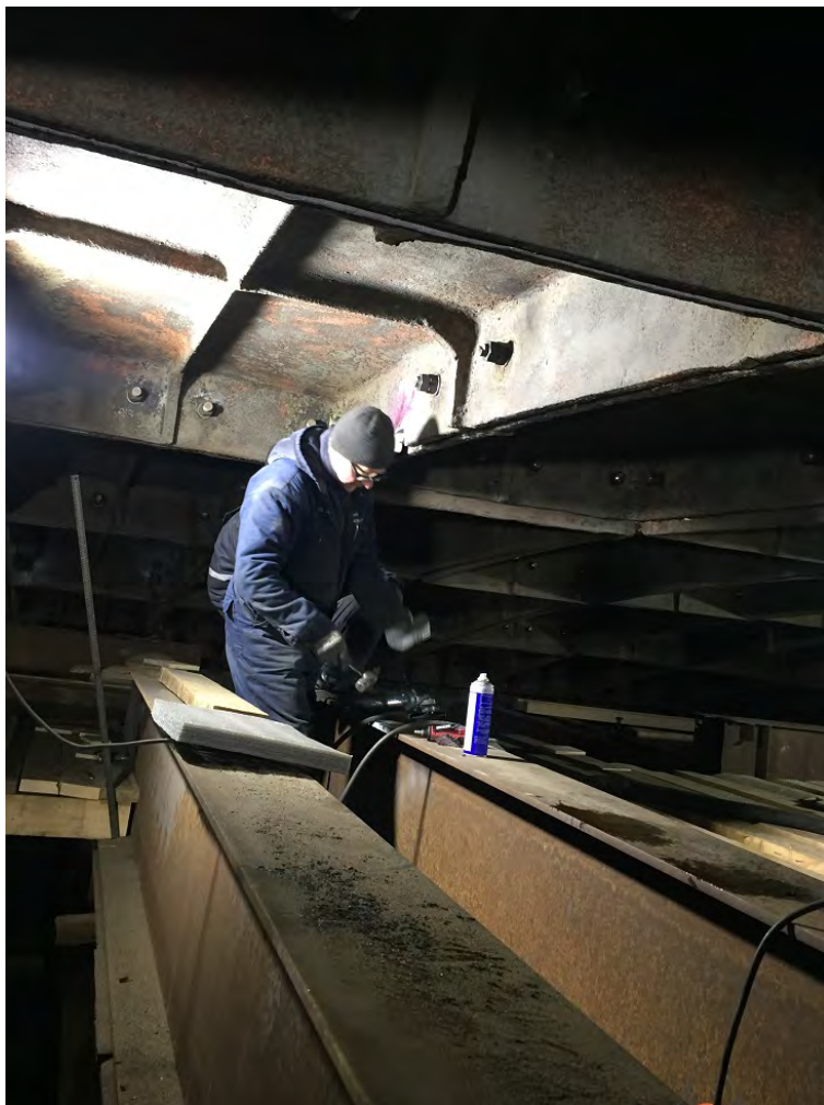
Определение объемов работ с помощью цветной дефектоскопии
